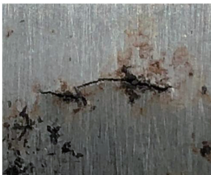
图 5 典型的外部应力腐蚀裂纹
